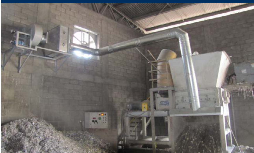
Imagen 2. Trituradora de residuos, Municipio de Puerto Cortés
