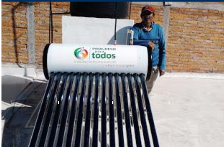
Imagen 1. Aprovechamiento de la energía solar térmica mediante la utilización de CSA
