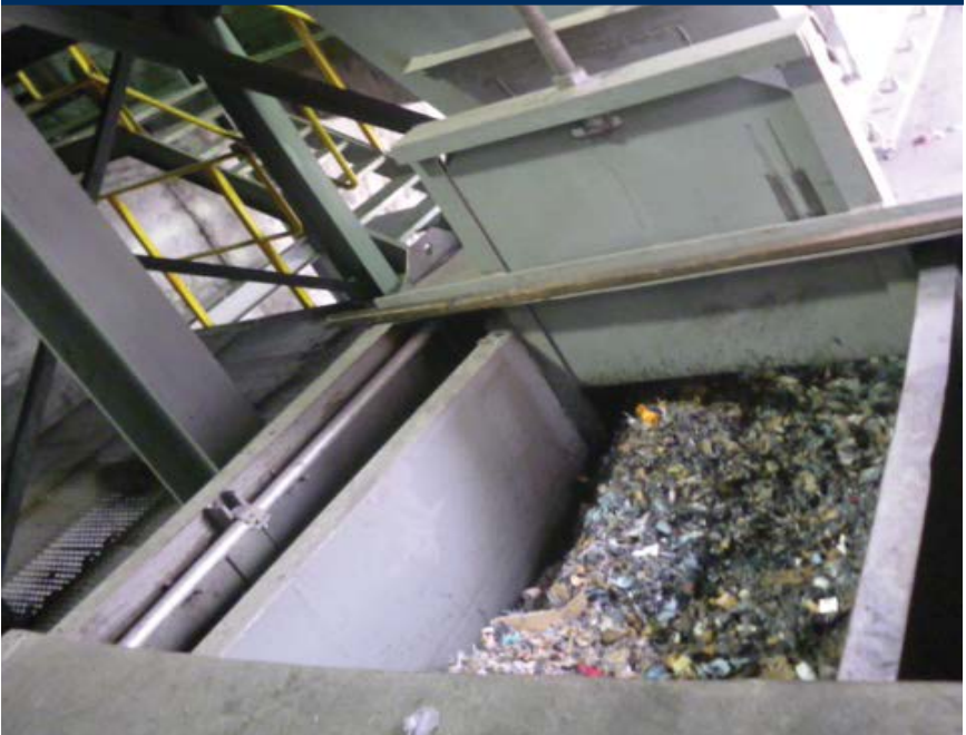
Imagen 4. Tolva con descarga hacia banda pesadora, Municipio de Puerto Cortés
